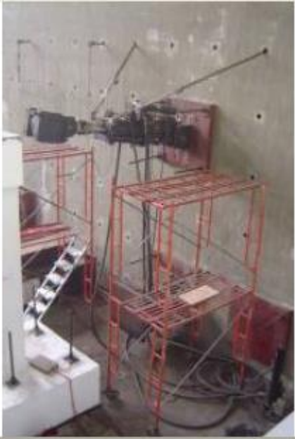
施工架工作臺及爬梯週邊無護欄
